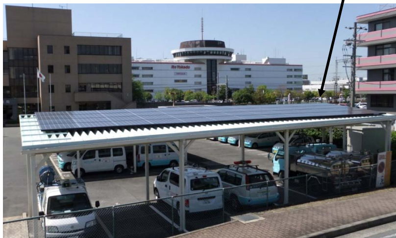
(写真2) 北駐車場 (パネル48枚。北側から撮影)
