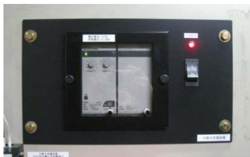
(写真4) 地絡過電圧継電器 (地下電気室に設置)
